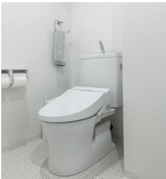
Typisches japanisches WC mit Dusch-WC-Aufsatz und Waschbecken über dem Spülkasten zur Grauwassernutzung.
